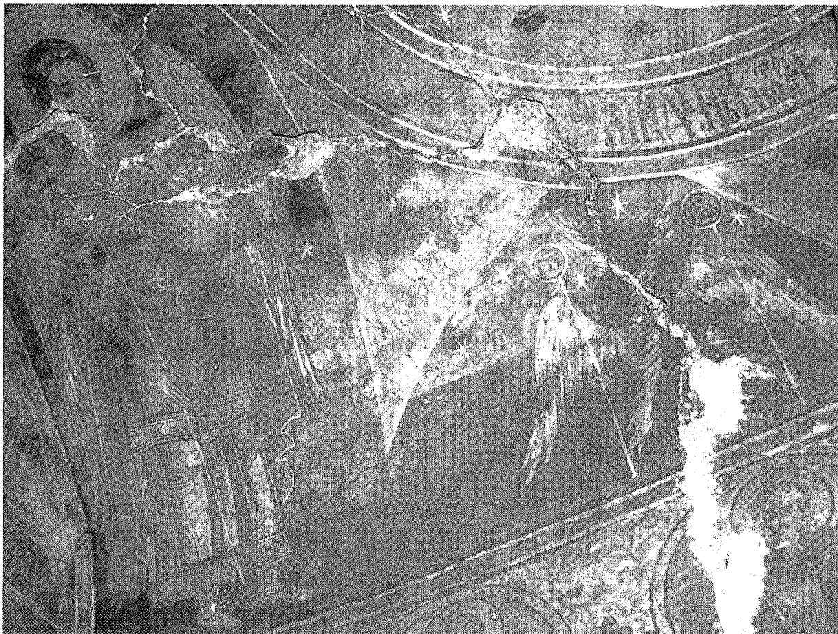
14. fisuri pronaos - perete catre sud
